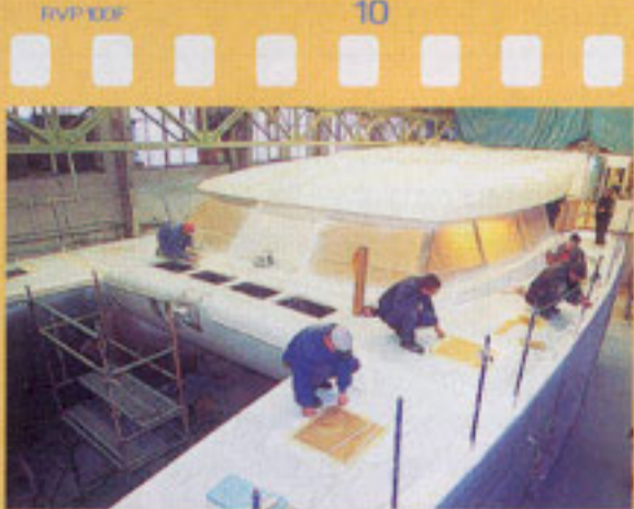
Finitions: cloisons et pont posés, le bateau passe dans cet atelier pour recevoir l'accastillage et le mobilier intérieur.
